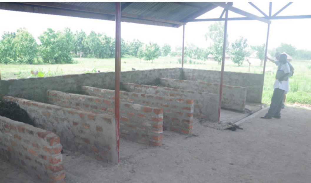
Immagine 10 Impianto di produzione di compost al coperto
